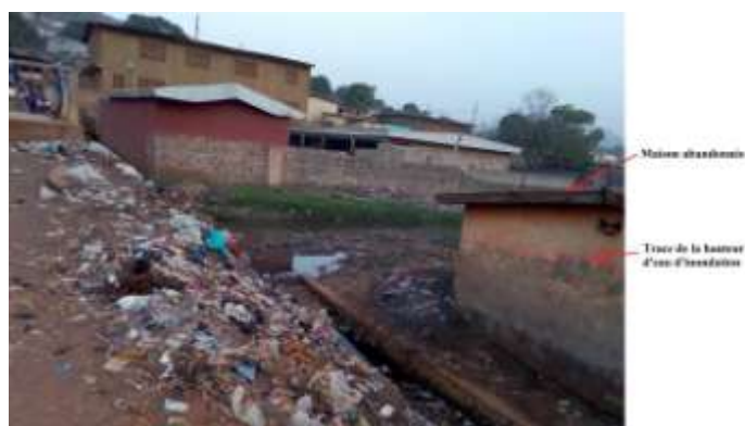
Traces laissées par la hauteur d'eau sur la maison pendant les inondations et dépôts sauvages (b) Figure 9:- Indices liés au débordement régulier du Kô au quartier Kennedy à Man (Photos prises le 22/02/2019) :
