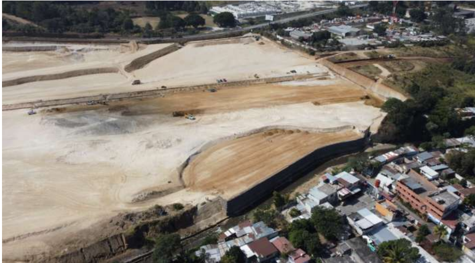
Figura 6:- Vista área del proyecto y el área de influencia de la estabilización con geosintéticos.
