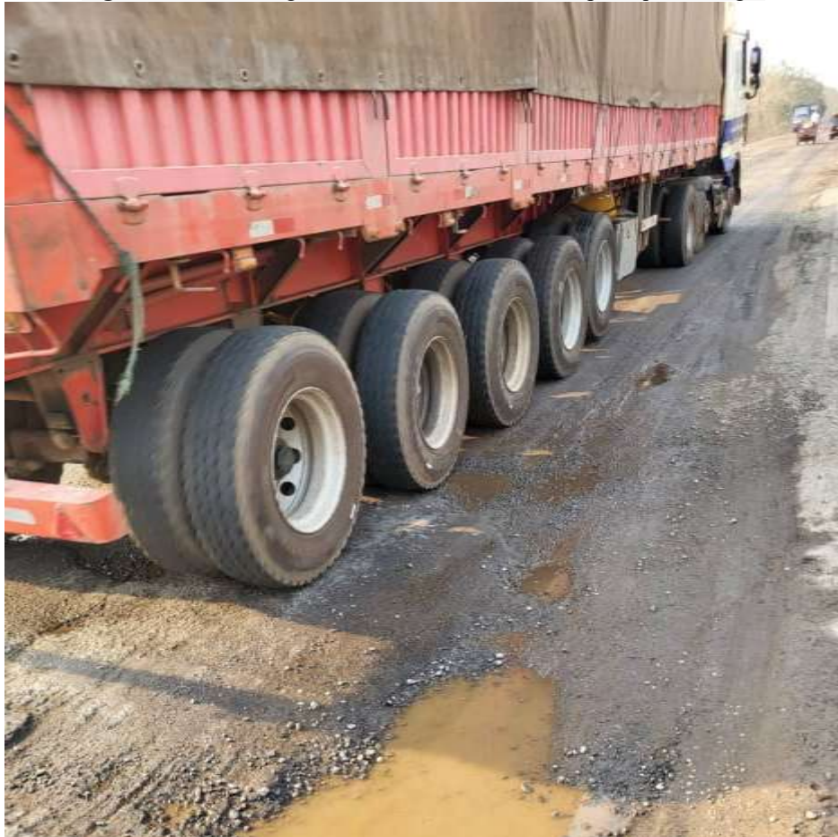
Figure 2:- État de dégradation d'une chaussée en République du Togo.
