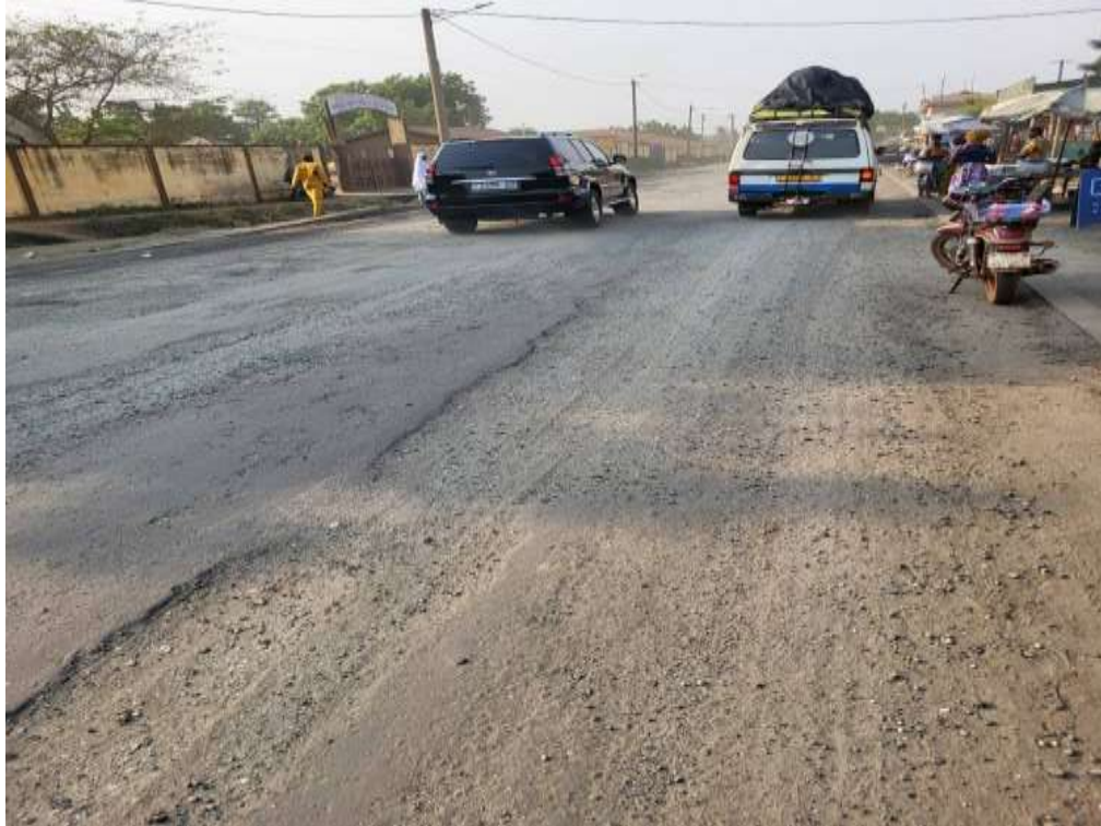
Figure 4 : Usure causée par un départ de matériaux du revêtement en béton bitumineux sur la N1 dans la ville de Notsé.
