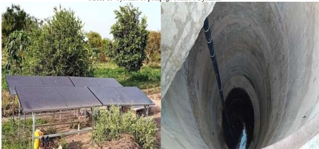
Photo 1:- Système de pompage solaire à Djannah.
